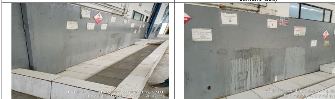
Fotografía 8 y 9. Antiguo espacio para depósito de RESPEL (aceite usado, thinner y material contaminado)
