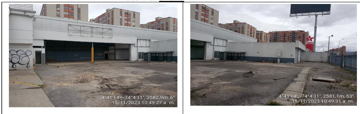
Fotografía 30 y 31. Antiguo parqueadero con placa de concreto fracturada
